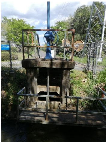
写真 15. 一の矢幹線からの分岐の例 一の矢宿舎と防災研を隔てる市道の地下を通る。 この道を進むと一ノ矢八坂神社に行き着く。 これが一の矢幹線の名称の由来であろう。 なお、この支線はまもなく花室川にも流入する。
